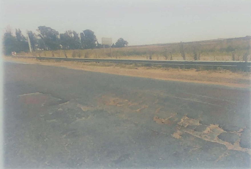
Foto N° 3 Deformaciones y Baches
