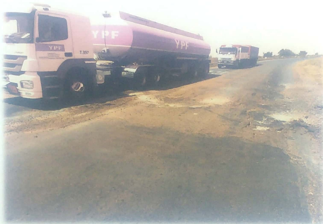
Foto N° 1 Deformaciones y Baches
