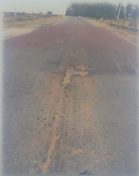
Foto N° 4 Deformaciones y Baches
